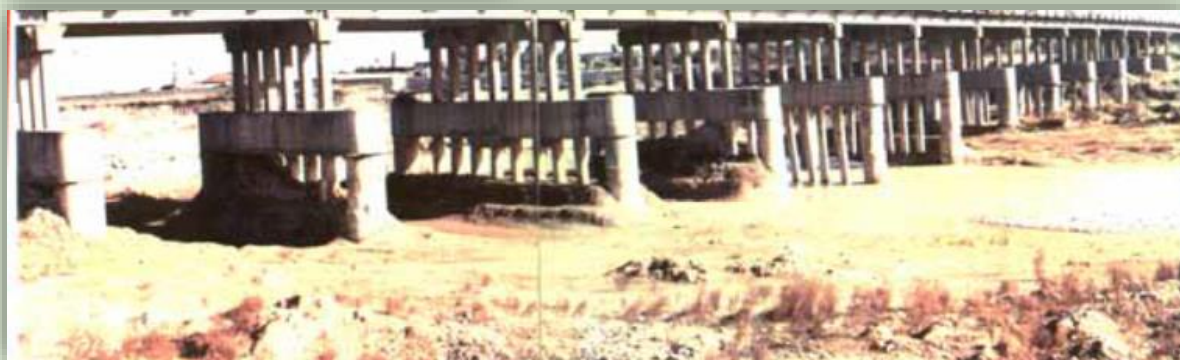
آب شستگی پایه های پل رودخانه تالار در اثر برداشت شن و ماسه از رودخانه
