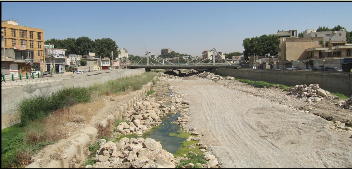
عبور تاسیسات از بستر رودخانه
